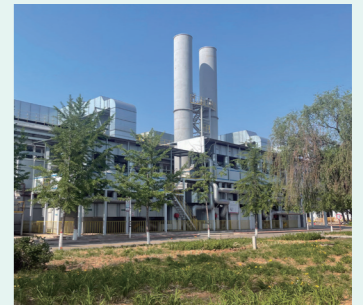
废气治理设备
