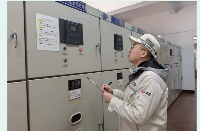
员工监测供电系统运行数据
