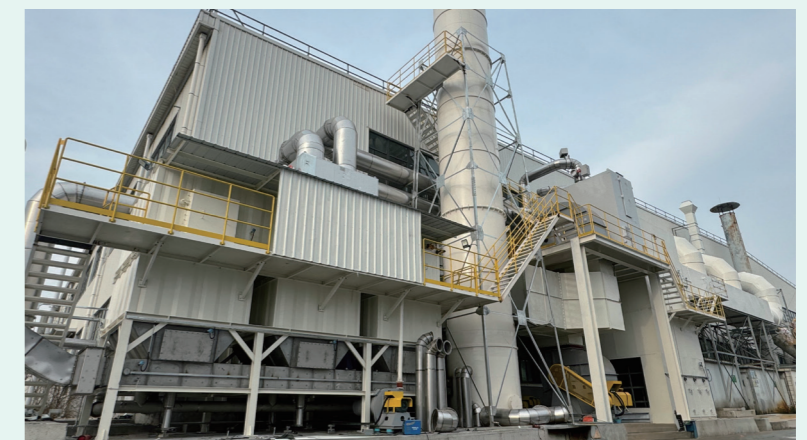
废气治理设备
