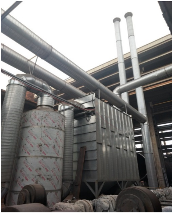
喷丸废气除尘装置
