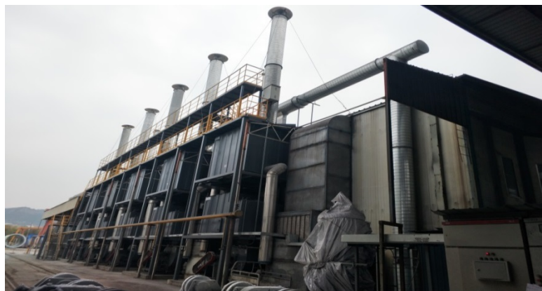
图4-2 喷漆、烘干废气处理装置
