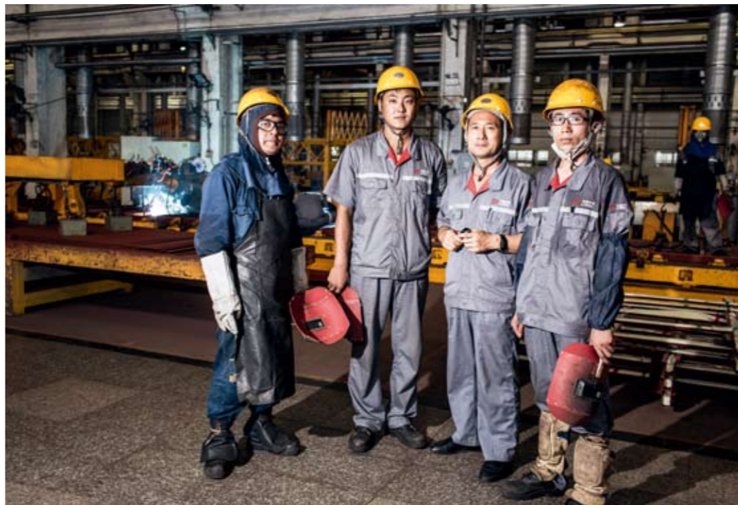
张东义（右二）和徒弟们在一起。钢结构车间里，四处是焊接飞溅的火花，高温天里，工人们汗流浹背。 摄影 段藏/人民画报
