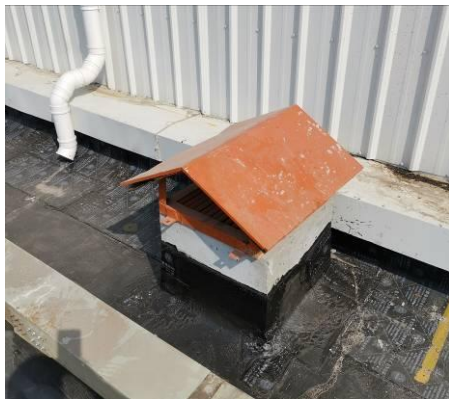
曝光室室顶进风口
