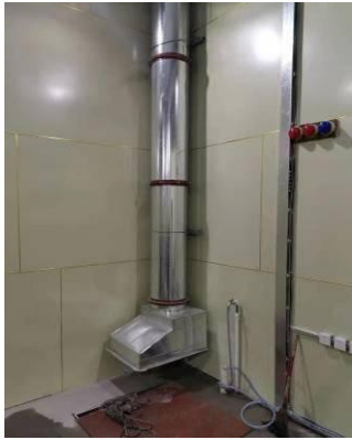
曝光室内风道
